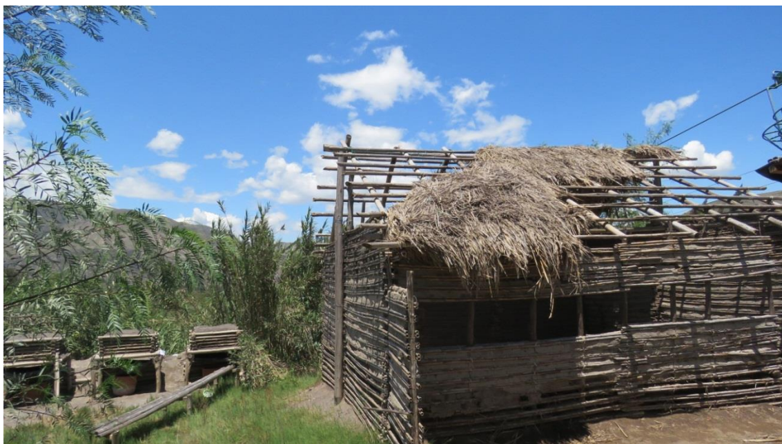
Figura 34. Deterioro del Museo de Sal de Salinas
