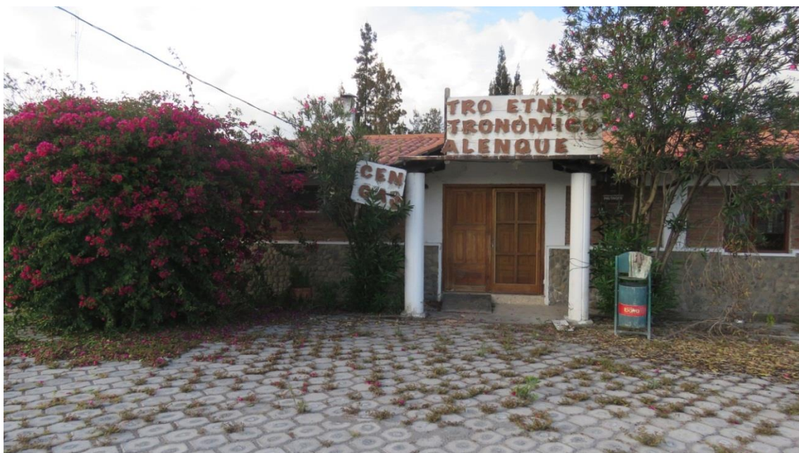
Figura 35. Deterioro de los exteriores del Centro Gastronómico Palenque
