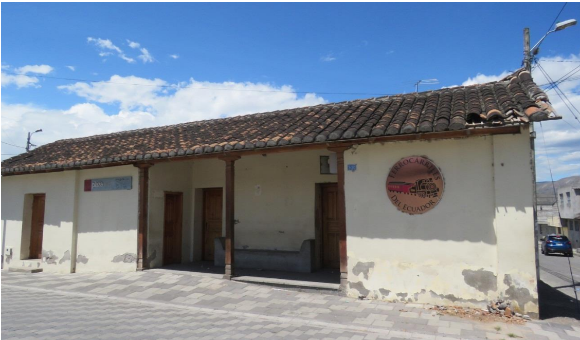
Figura 37. Deterioro de la infraestructura de la Plaza Artesanal de Salinas
