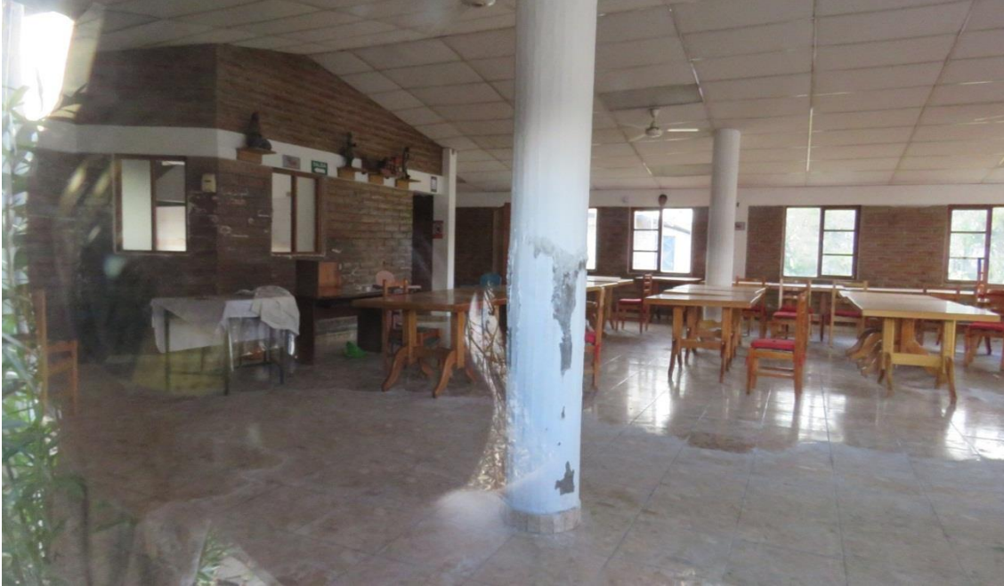
Figura 36. Deterioro del interior en el Centro Gastronómico Palenque
