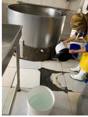
Figura 31. Desinfección de pisos
