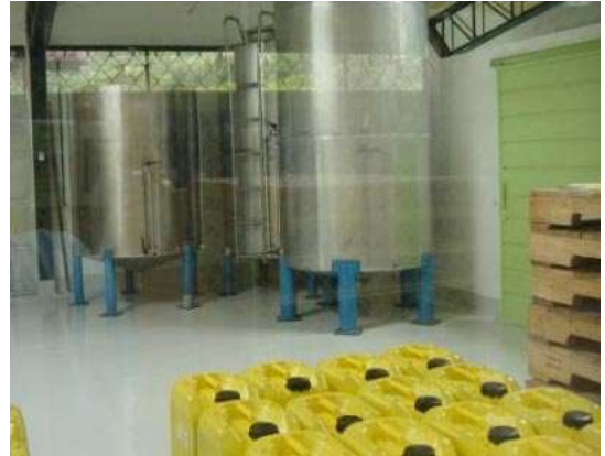
Tanques de producto terminado
