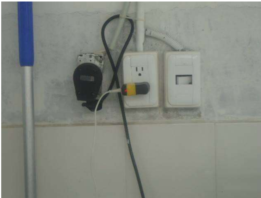
Figura 10. Interruptores sin protección
