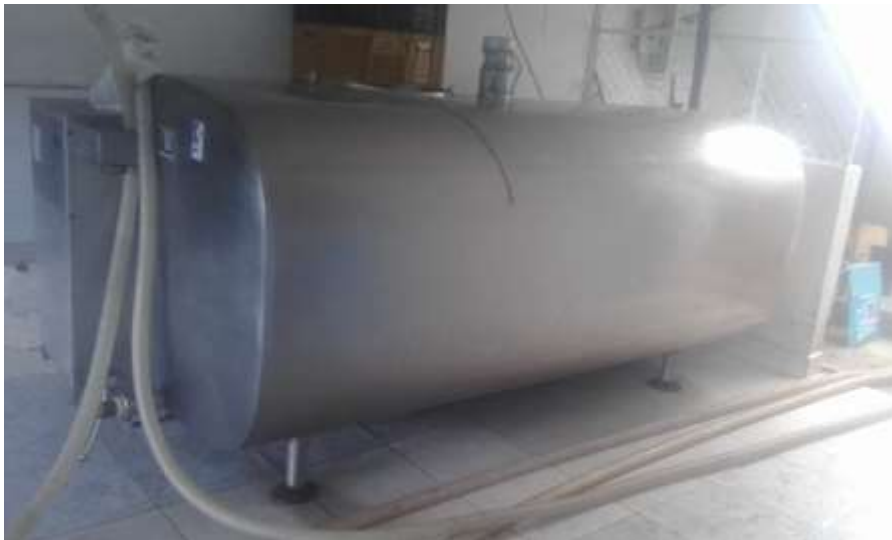
Figura 20. Tanque de enfriamiento
