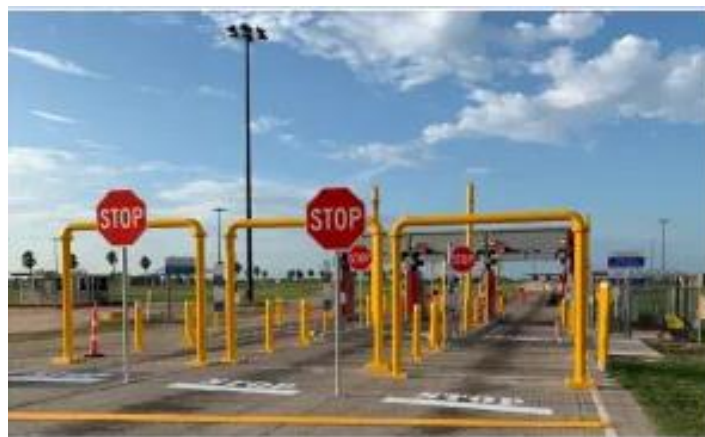
Ilustración 38. Sistema de portal de bajo consumo energético rayos X y monitoreo radiológico en el puerto de entrada internacional
