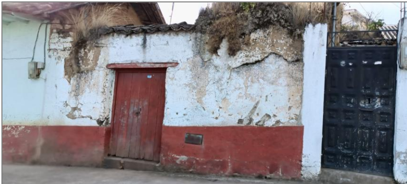
Inmueble patrimonial deteriorado
