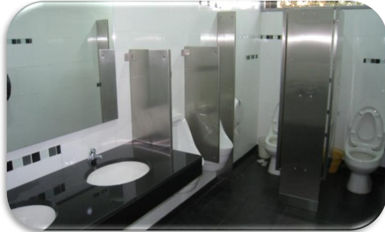
Gráfico 14.- Instalaciones sanitarias para empleados.
