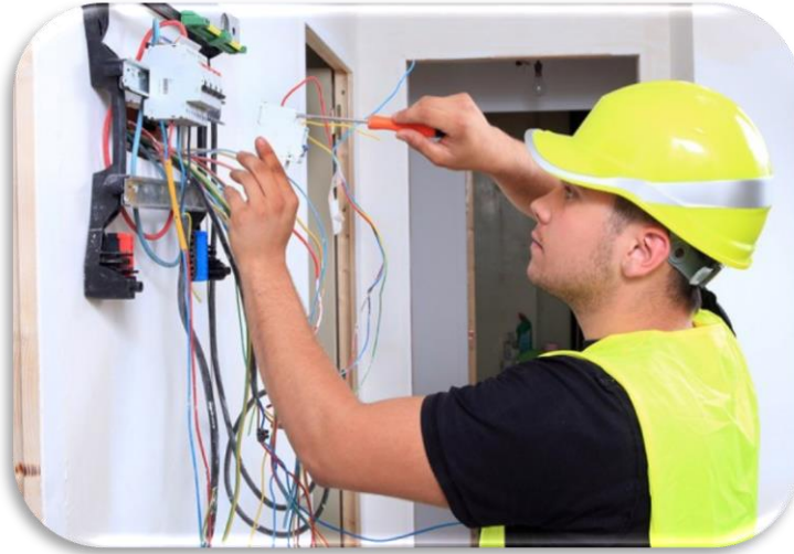
Gráfico 9.- Instalación de red eléctrica para industria.
