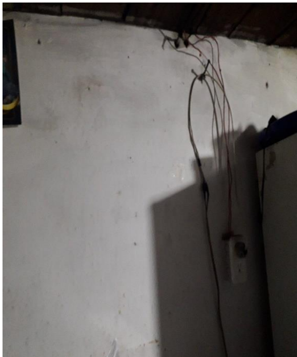
Figura 43. Antes cables de luz sin protección.
