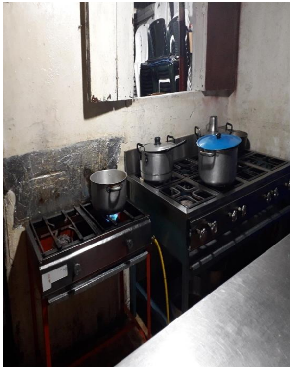
Figura 41. Antes sin láminas protectoras en las paredes de las áreas de preparación, lo cual no facilitaba una fácil limpieza y desinfección de vapores y grasas que se acumulaban.
