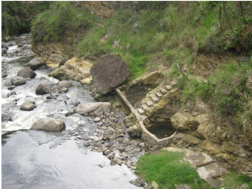
Infraestructura de las termas Blas Ángel en abandono, a orillas del río El Ángel
