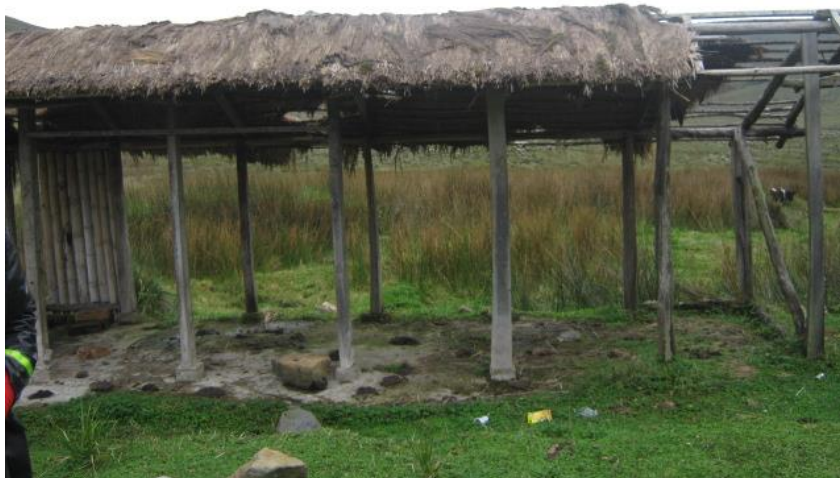
Infraestructura deteriorada del Balneario El Artezón
