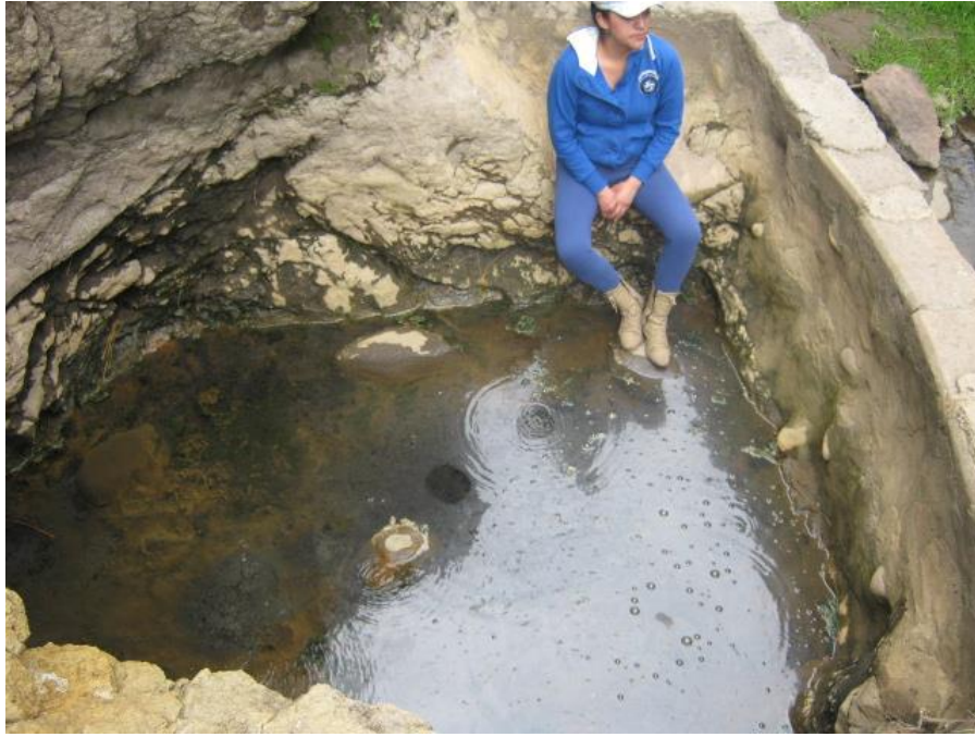
Vista del agua aceitosa debido a la maleza que cae ahí
