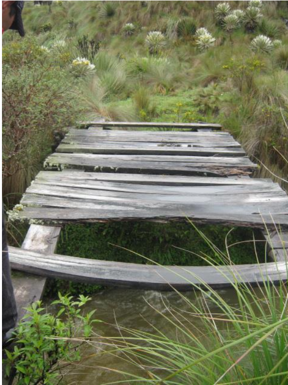
Puente deteriorado que conduce al Balneario El Artezón
