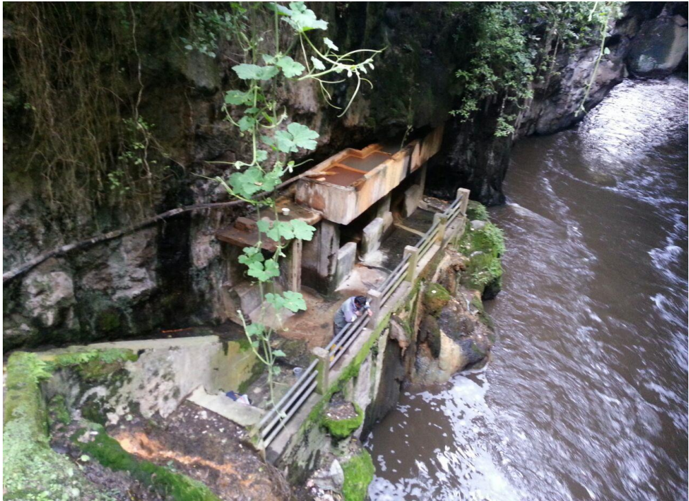
Vista de la infraestructura en mal estado del Balneario La Olla
