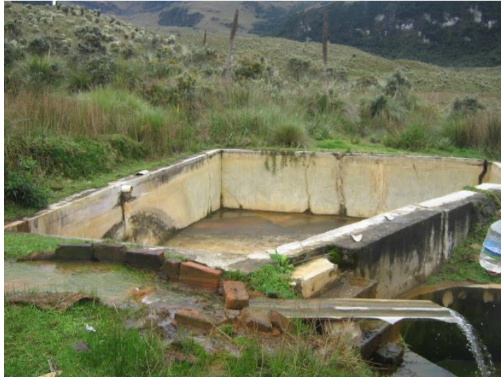
Piscina deteriorada de El Artezón, en la parte de atrás se puede observar frailejones
