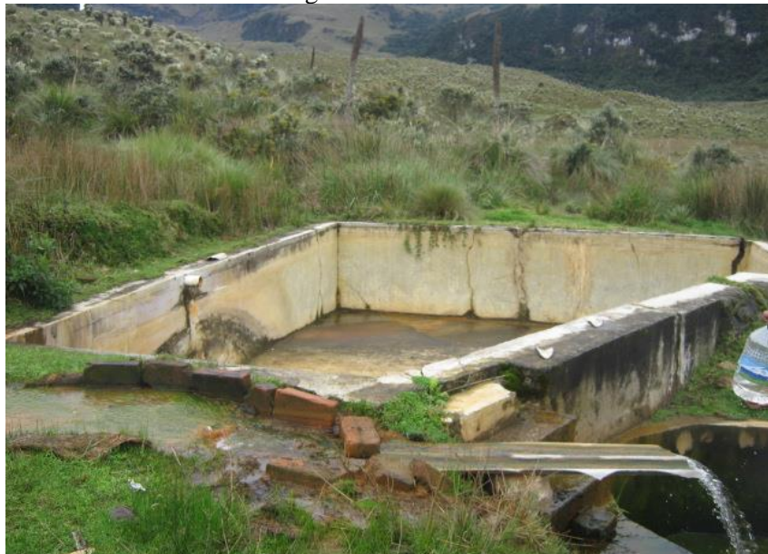
Piscina deteriorada del Balneario Artezón, rodeada de frailejones Junto a vertiente de agua termal
