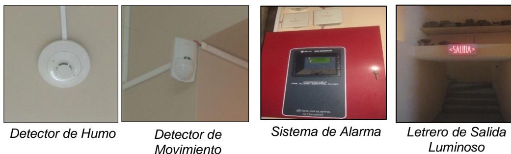
Figura 6. Medidas de Seguridad utilizadas en el espacio de Almacenaje
