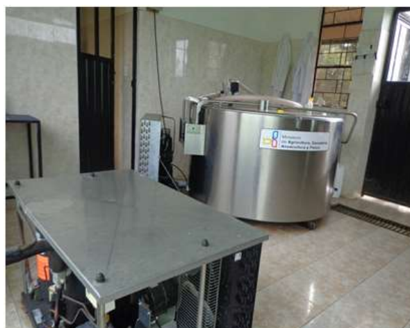
CUARTO DE ENFRIAMIENTO
