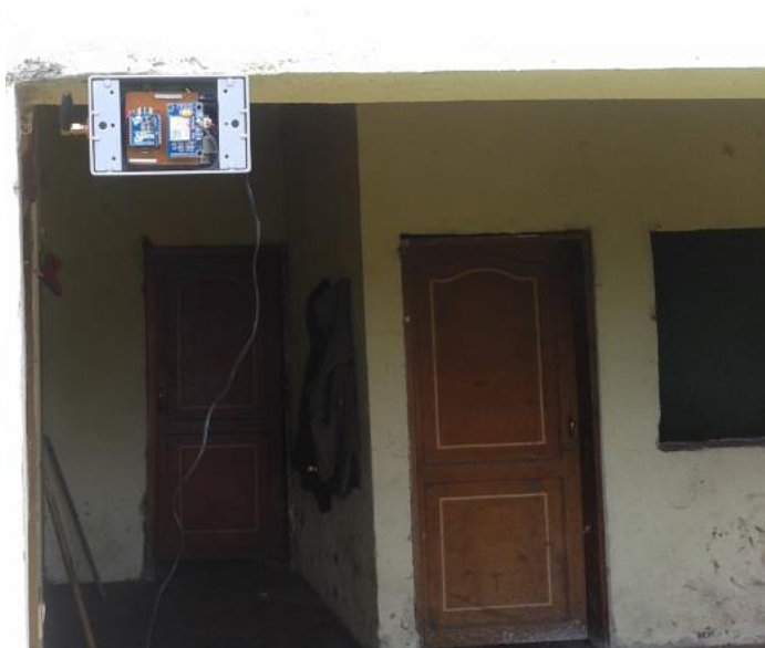
Figura 79. Dispositivo coordinador adecuado en una caja de protección.
