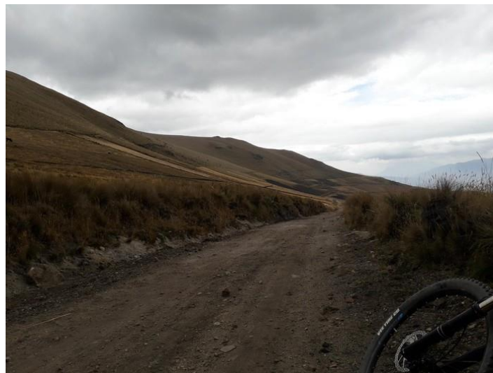
Figura 84. Estado del camino de pambamarca
