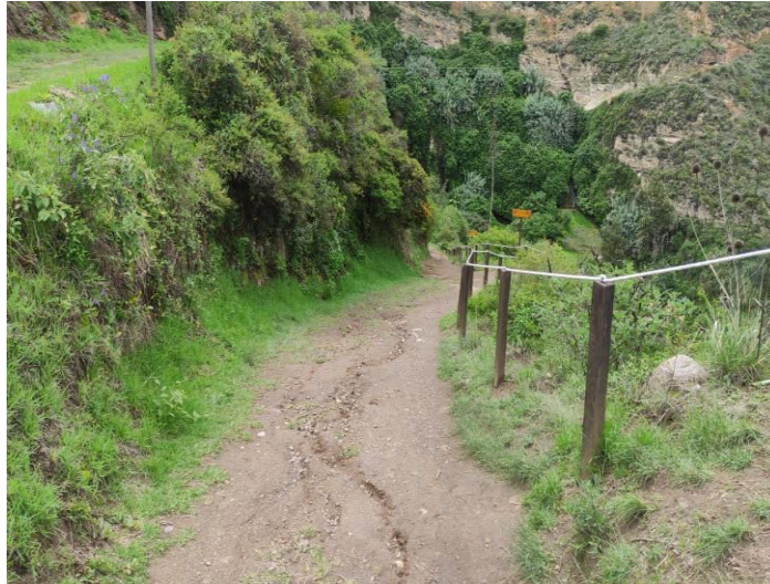
Figura 95. Hundimientos de terreno el tingo
