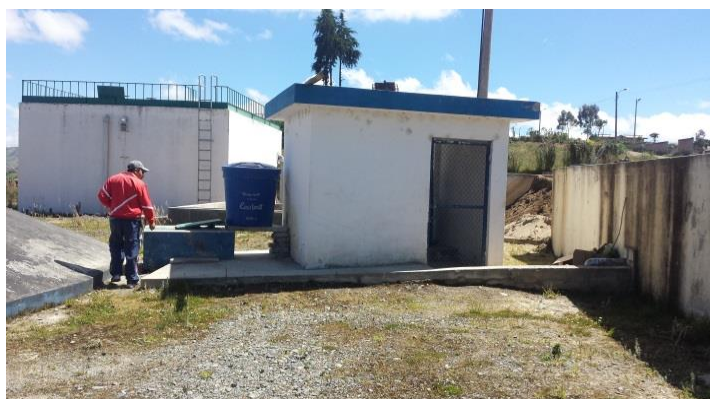
Sistema de cloración planta de tratamiento Yambá- 09/06/2014
