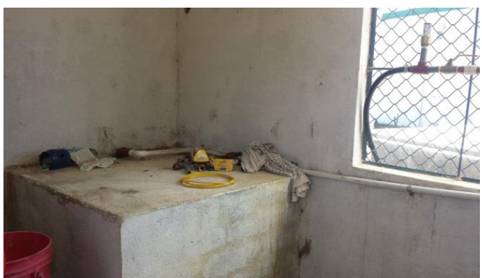
Sistema de cloración planta de tratamiento Yambá-09/06/2014
