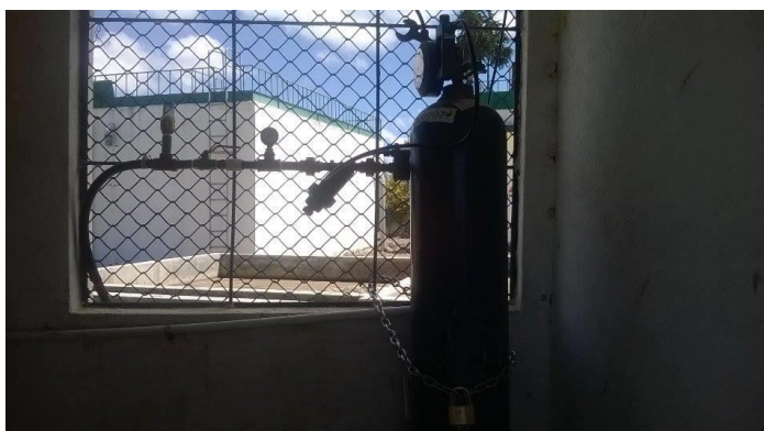
Sistema de gas clorado planta de tratamiento Yambá-09/06/2014
