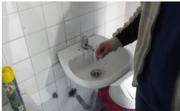
Toma del agua - Subcentro de salud de Huaca- 22/07/2014.
