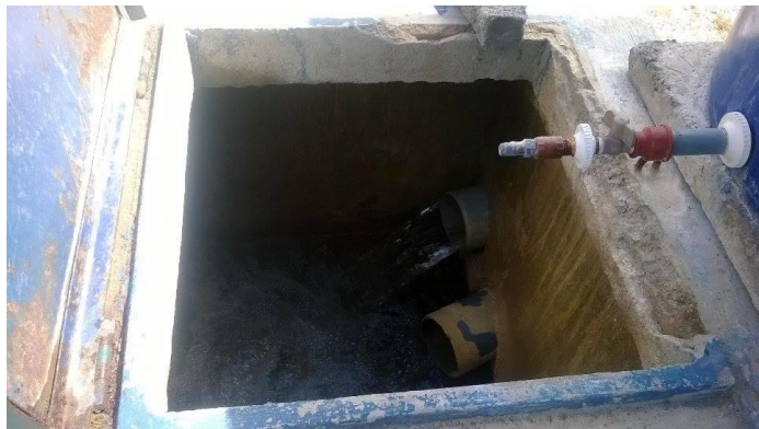
Sistema de cloración planta de tratamiento Yambá-09/06/2014
