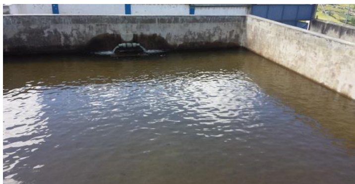
Sedimentación y filtración Yambá-San Pedro de Huaca-09/06/2014
