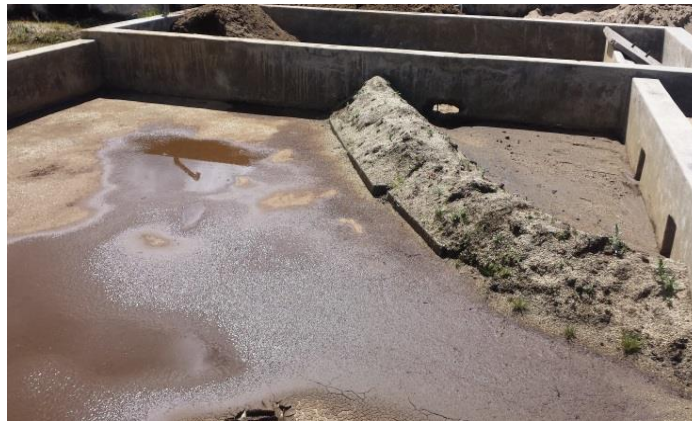
Sedimentación y filtración Yambá-San Pedro de Huaca-09/06/2014
