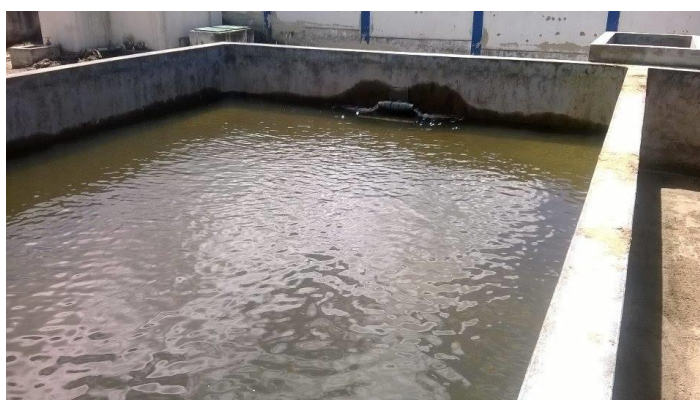
Sedimentación y filtración Yambá-San Pedro de Huaca-09/06/2014
