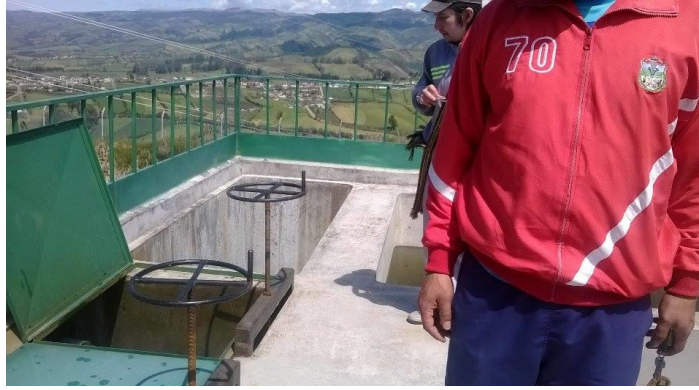
Visita planta de tratamiento y de distribución de agua Yambá- Wilmer Quelal -09/06/2014
