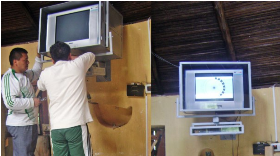
Foto 22 Colocación de TV, dentro del Bohío Fuente: Elaboración Propia
