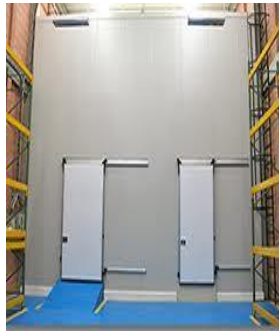
Cuarto frío de 90 m3
