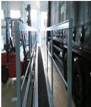
Pasarela de servicio con escalerilla
