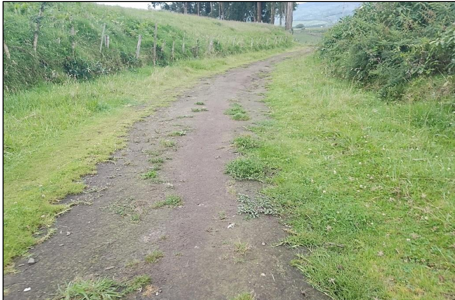
Figura 6. Afectaciones de la sección de camino
