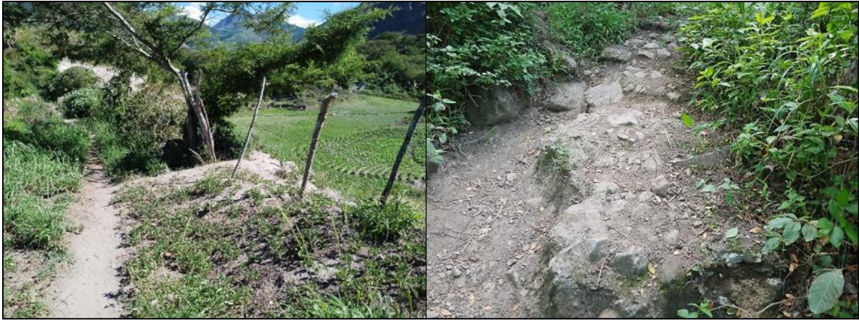
Figura 19. Estado de conservación
