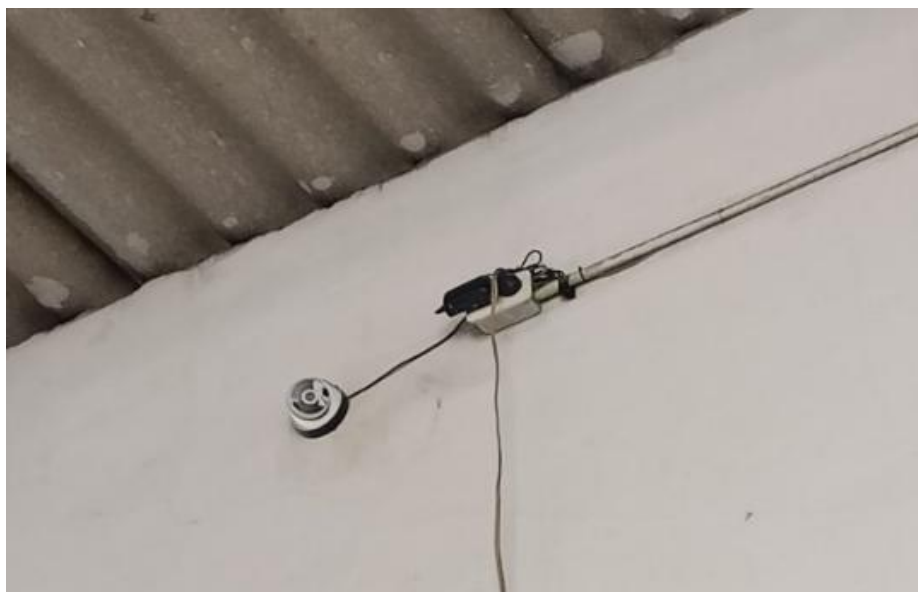
Figura 12. Seguridad - Cámaras de vigilancia
