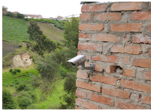
Cámara de vigilancia posterior
