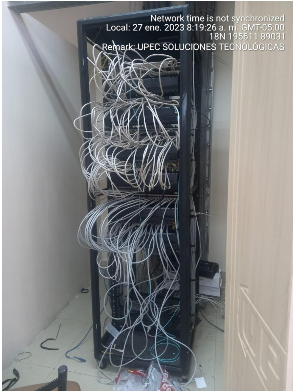
Figura 63. Situación de Rack de telecomunicaciones
