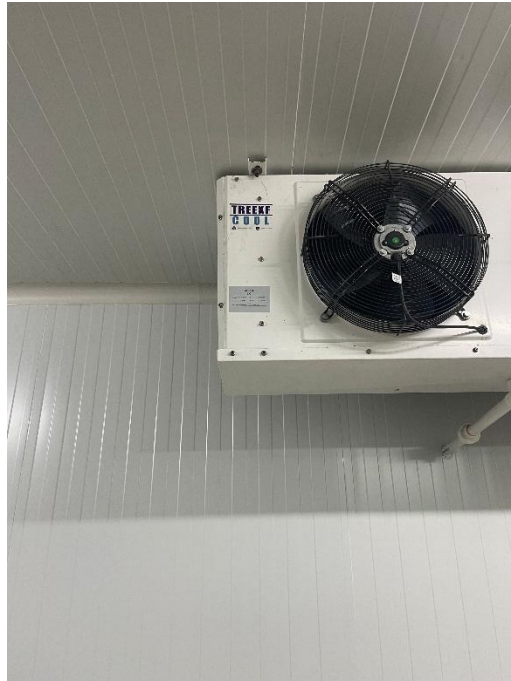
Figura 1. Equipo de refrigeración, de la finca Ramona
