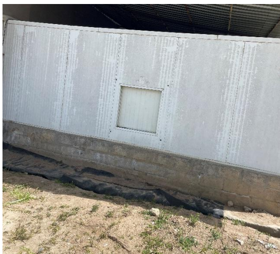
Figura 4. Infraestructura de carga y descarga, Finca Bolívar
