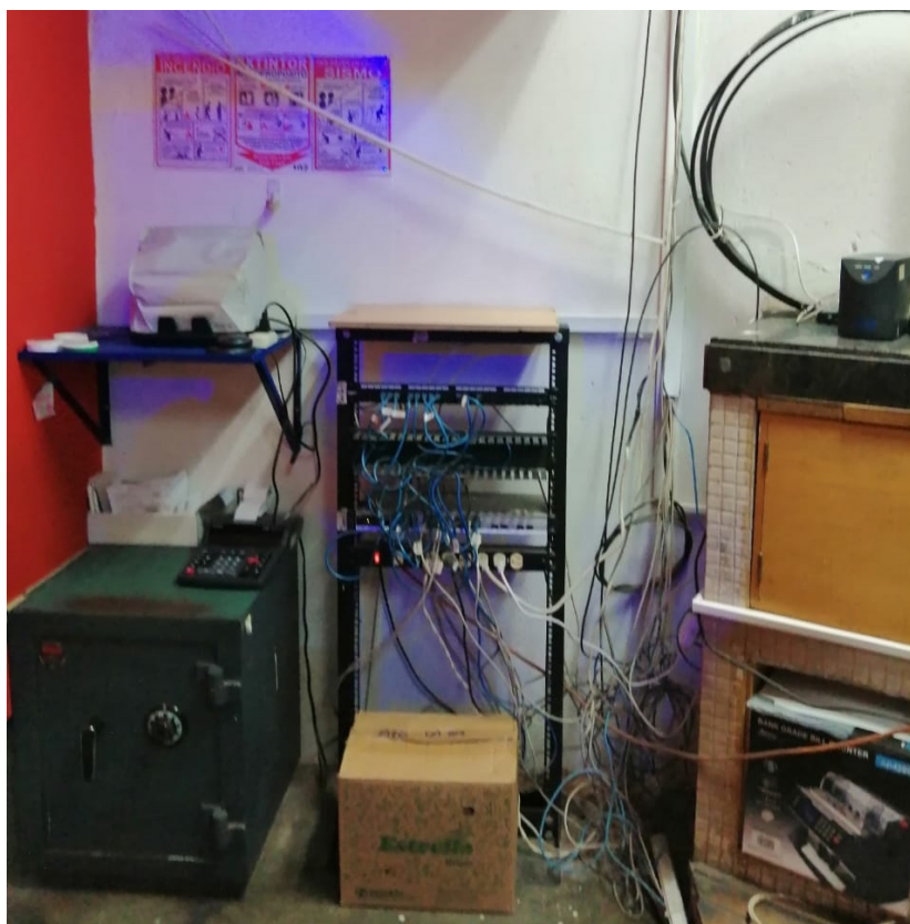
Anexo 17: Estado actual de los Racks en el GADMT
